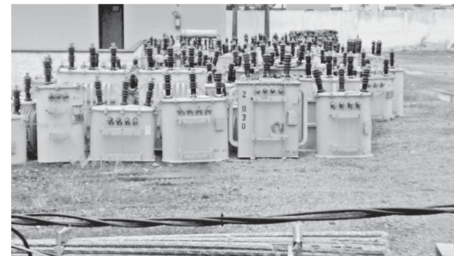
É de dar dó: transformadores aguardam manutenção no pátio da Agência de Rio do Sul
